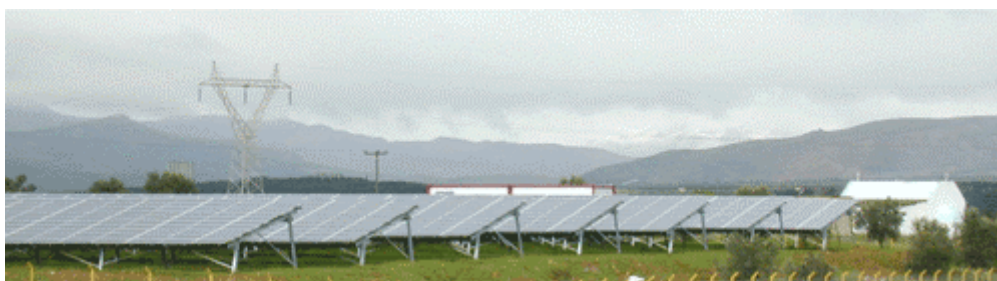
Ηλιακός σταθμός ηλεκτροπαραγωγής στην Κρήτη
