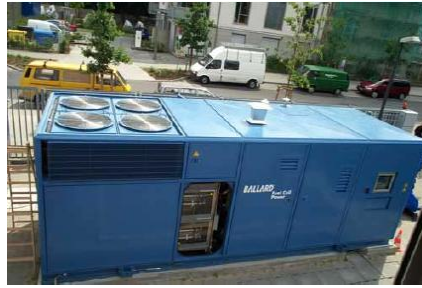
Μονάδα ηλεκτροπαραγωγής 250 KW (τεχνολογίας PEM) της Astom Ballard στο Βερολίνο
