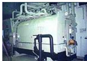
Από το σύστημα στα Οινόφυτα. Με ηλιακή ενέργεια, δύο ψύκτες συνολικής ισχύος 700kW παράγουν κρύο νερό 8–10 βαθμών. Το σύστημα ελέγχεται αυτόματα από υπολογιστή.
