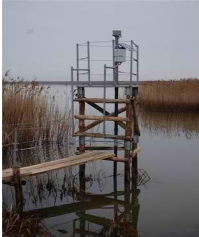
Εικόνα 7. Τηλεμετρικός σταθμός Λίμνης Ισμαρίδας
